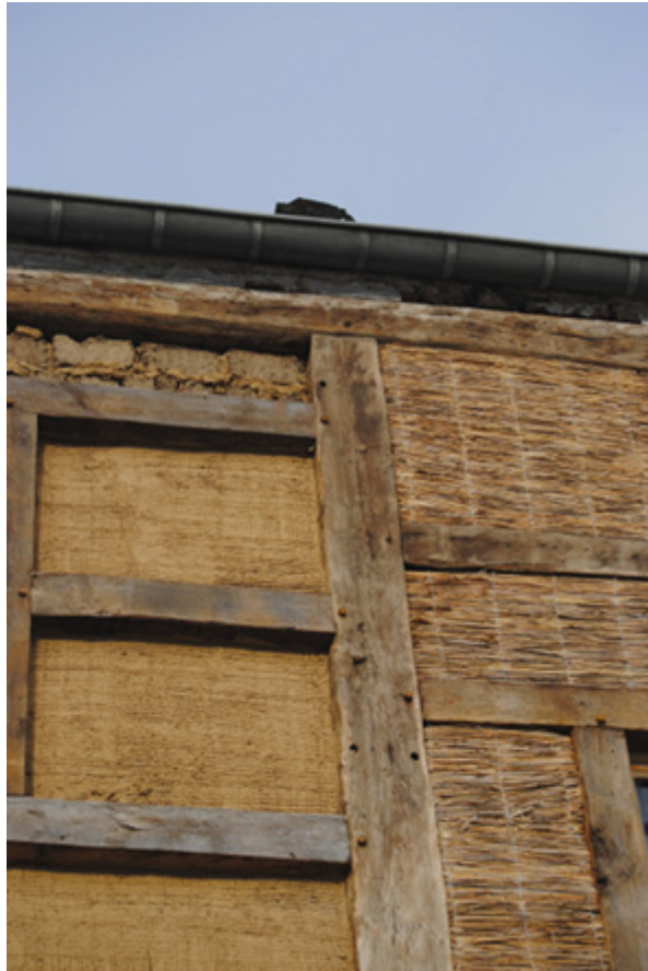
Façade en restauration en colombage et torchis. Source : Sophie Bronchart - produits Claytec
